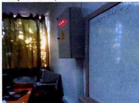
Fotografía N° 10: inexistencia de ventiladores en sala de computación.
