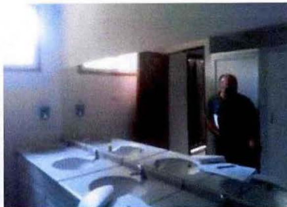
Fotografía N° 4: 4 lavamanos en baño damas.
