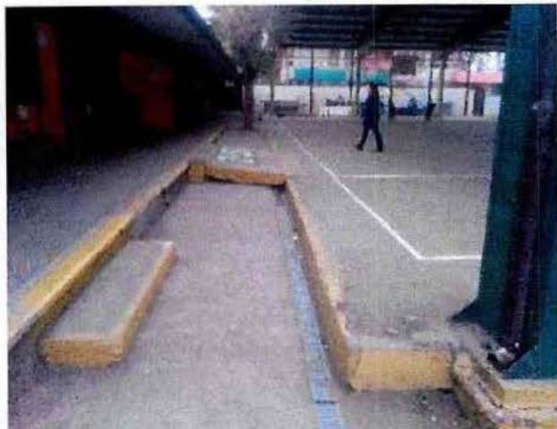
Fotografía N° 1: Inexistencia de solerillas en torno a multicancha
