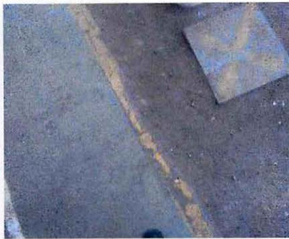
Fotografía N° 2: Inexistencia de solerillas en torno a multicancha
